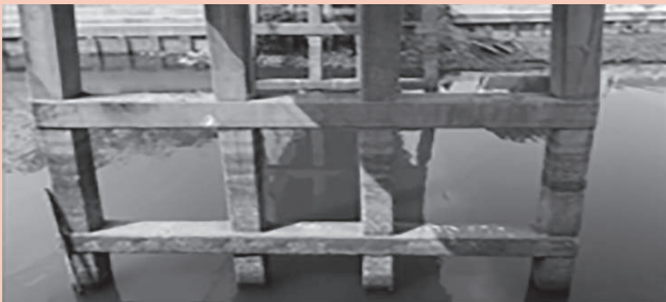
สภาพต่อม่อสะพานคอนกรีตข้ามคลองหน้าวัด
